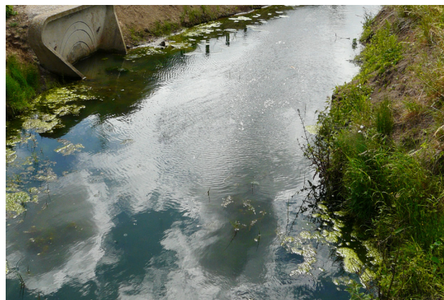
Évacuation des eaux pluviales à Fouquières-les-Béthune
