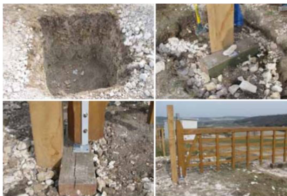
Technique de pose de barrière sans béton dans le boullonnais (Source: "Gestion des pelouses calcicoles sur le territoire transmanche", PNR Caps et Marais d'Opale)
